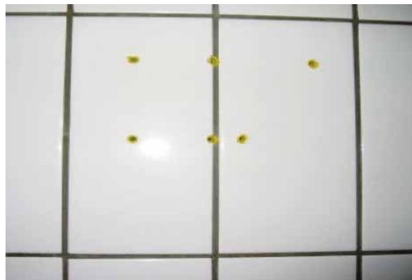
Borehuller i fliser på badeværelse.
